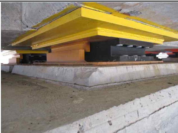
P4-Sh8 무수축물탈 파손(0.1m×0.1m)
