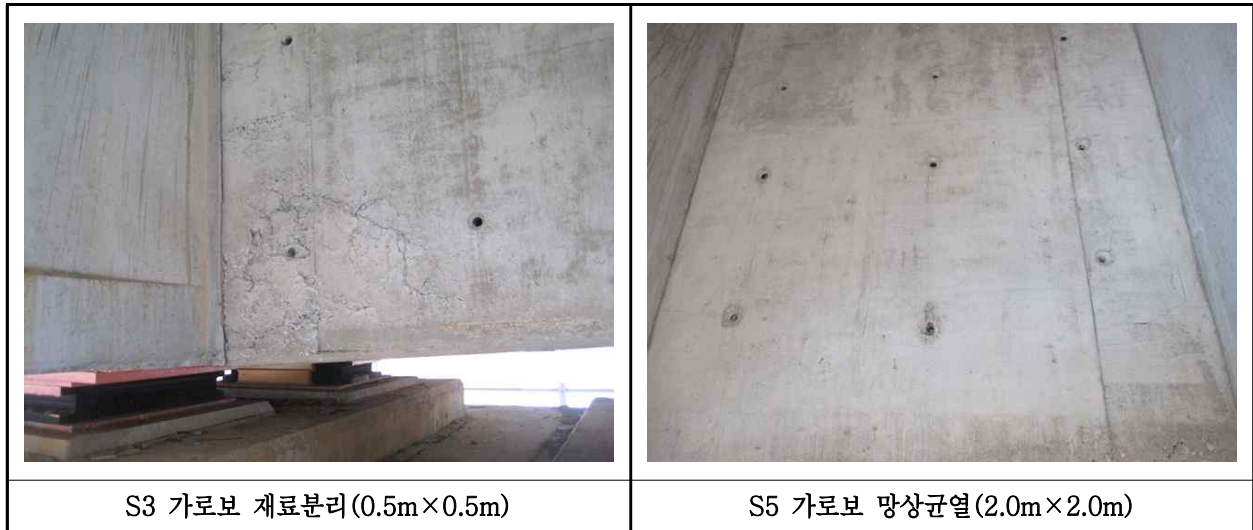
【사진 33.3.30】 가로보 손상현황
