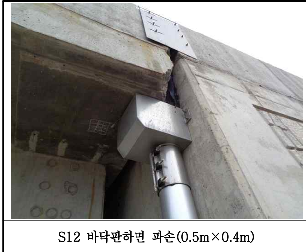
【사진 33.3.26】 바닥판하면 손상현황
