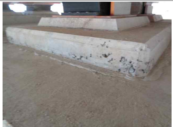
P9-Sh3 받침콘크리트 재료분리(1.0m×0.2m)
