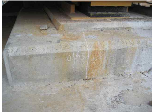
P2-Sh10 받침콘크리트 균열(0.1mm/0.5m)
