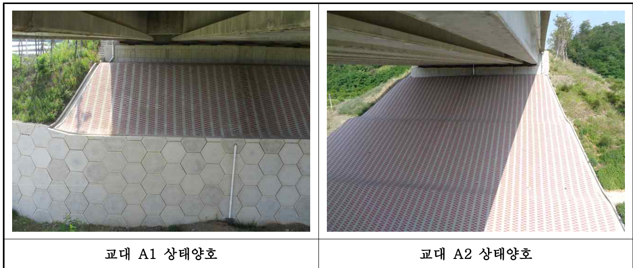
【사진 33.3.9】 교대 손상현황
