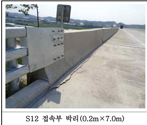
【사진 33.3.42】 교면포장 손상현황
